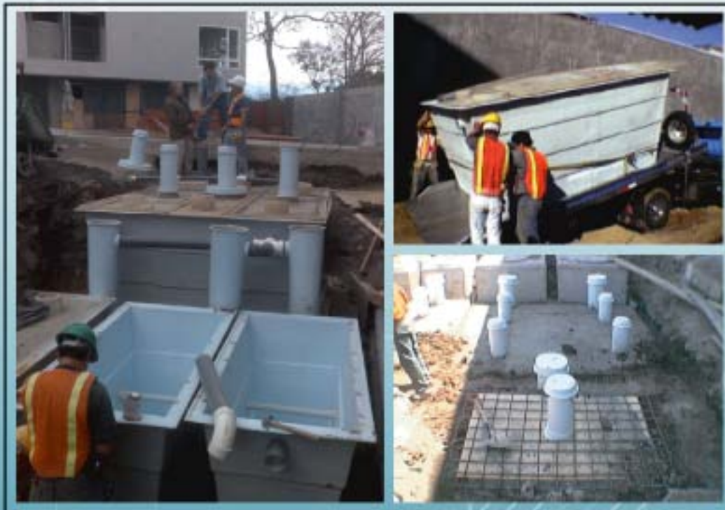
sistema de tratamiento instalado en Condominio Matisse San José, Escazú
