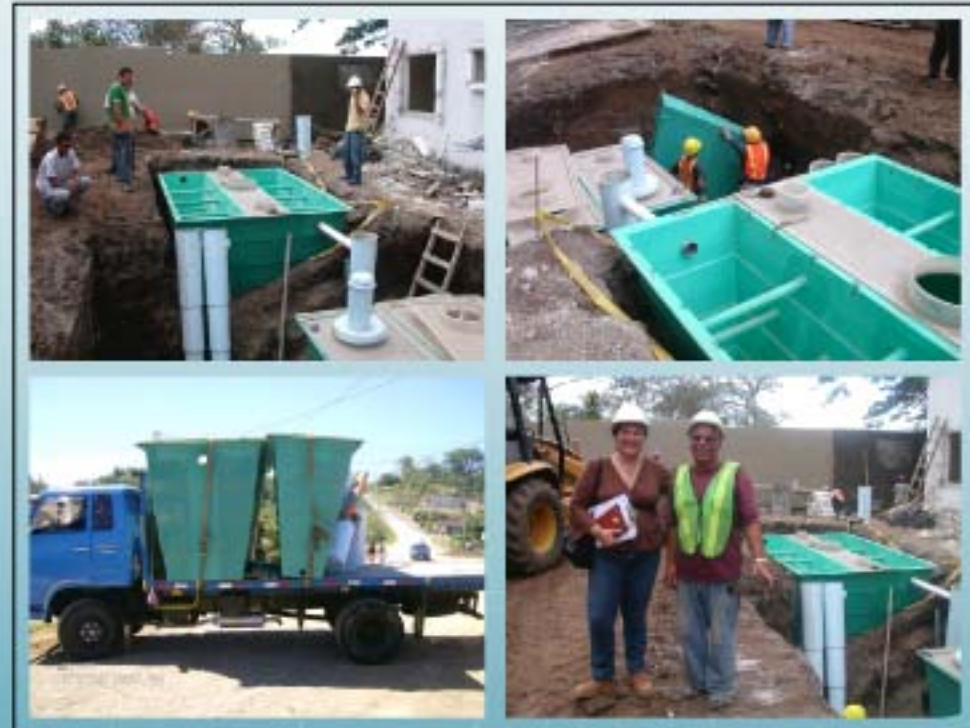
sistema de tratamiento instalado en Condominio Los Prados San José, Escazú
